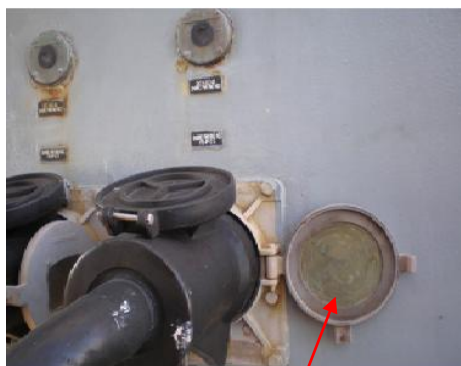
RECEPTACLE DOOR MISSING SEAL
